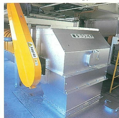
● 養生コンベア
