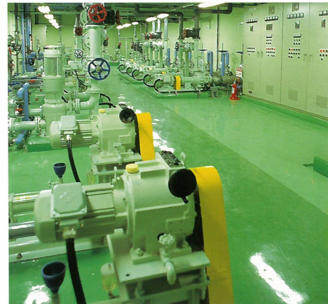
△ 地下ポンプ室
