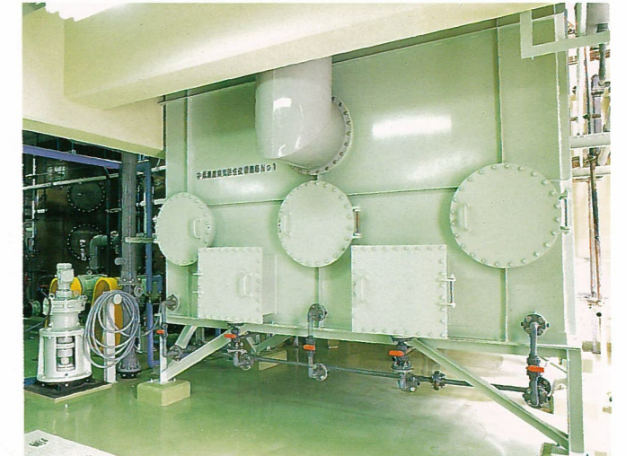
△ 活性炭脱臭塔
