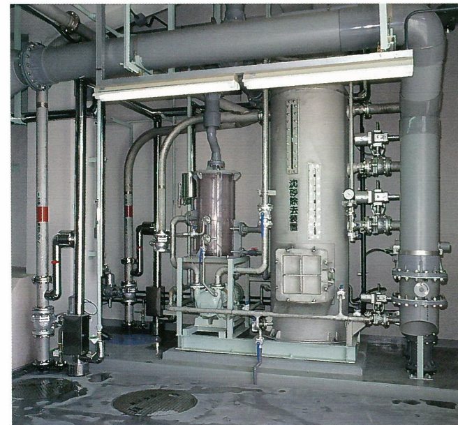
△ 沈砂除去洗浄装置
